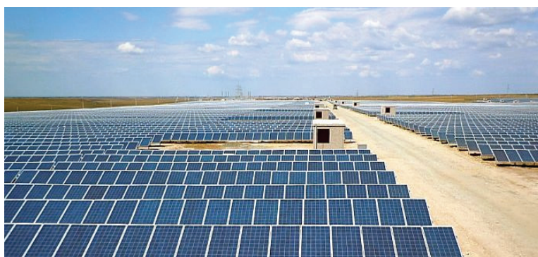
Рисунок 8 – Общий вид промышленной солнечной электростанции
